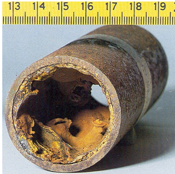
Mikrobiologische Korrosion von Karbonstahl in Trinkwasser durch sulphatredutierende Bakterien (identifiziertes Korrosionsprodukt)
