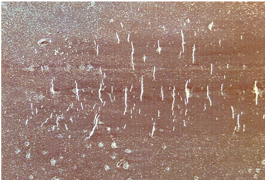
Spannungskorrosionsrisse in der Nähe der Schweißnaht im Karbonstahl nach 15 Jahre Betriebszeit in einer Entgaser
